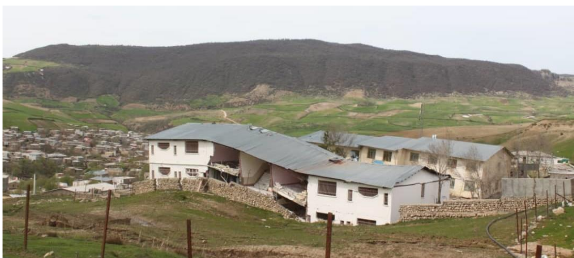
تخریب مدرسه شبانه‌روزی هاجر در روستای حسین‌آباد
