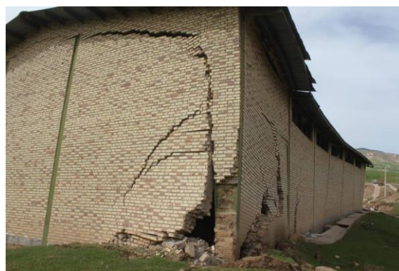
تخریب و شکست سوله ورزشی روستای حسین‌آباد
